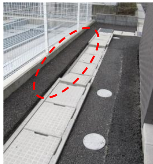
PU八乙女中央 外構の破損
