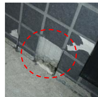
PF浅草駒形 外壁タイルの剥離
