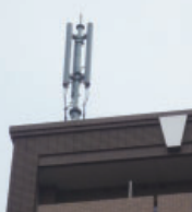
プライムアーバン葛西 携帯電話のアンテナ設置
